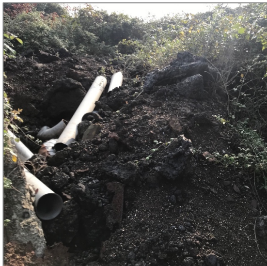
Particolare contenuto 'vasca fuori terra'
