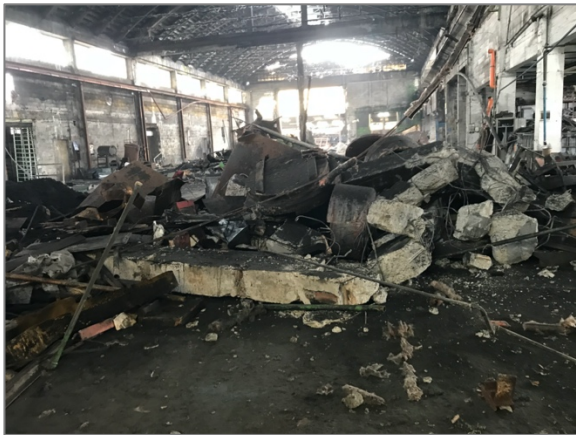
Residui di demolizione nel capannone principale
